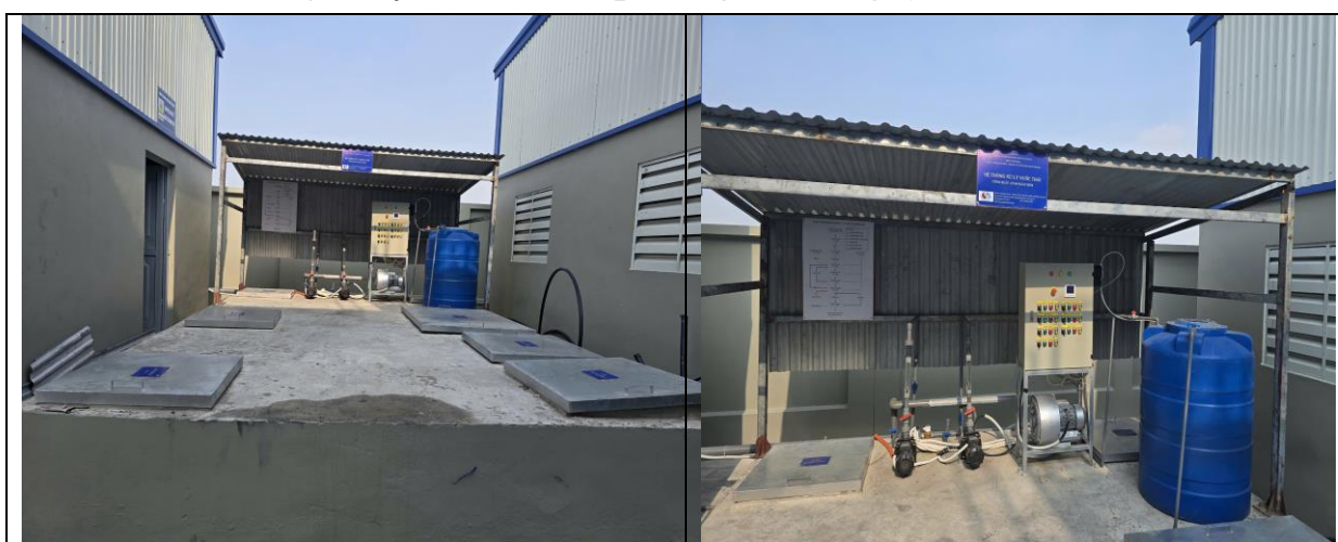
Hình 3.2. Hình ảnh hệ thống xử lý nước thải sinh hoạt của dự án
