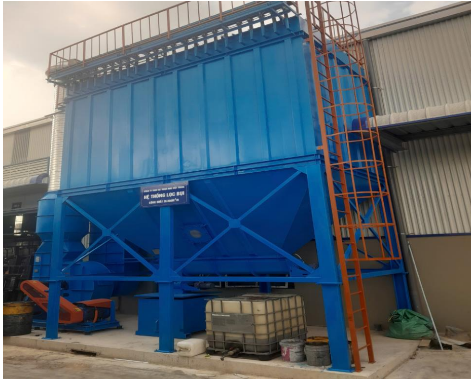
Hình 3.5. Hình ảnh hệ thống lọc bụi (công đoạn nạp liệu và trộn)
